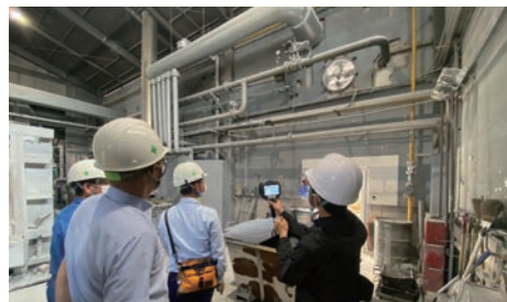
(写真1) 主製造設備の他付帯設備にもエア配管が多数敷設されている。
