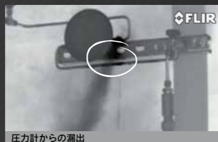
圧力計からの漏出
