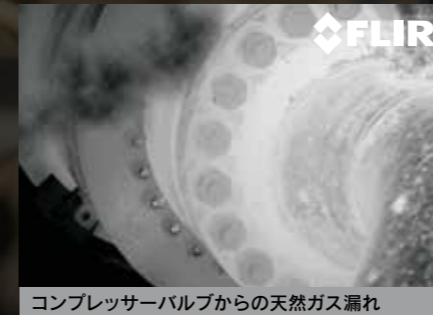
コンプレッサーバルブからの天然ガス漏れ
