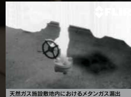
天然ガス施設敷地内におけるメタンガス漏出
