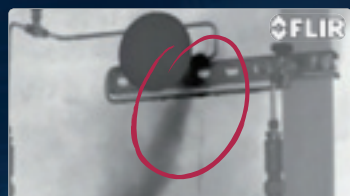
圧力計からの漏出
