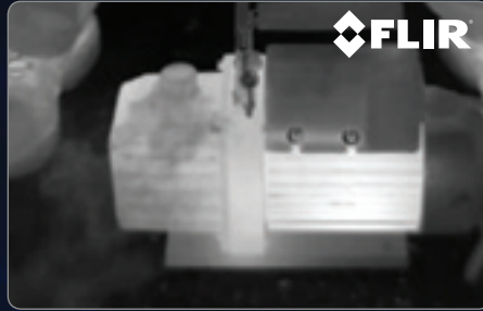
冷媒ガス漏出中のAC装置の光学ガス画像
