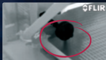
赤外線熱画像上にガス漏れをはっきりと視覚化
